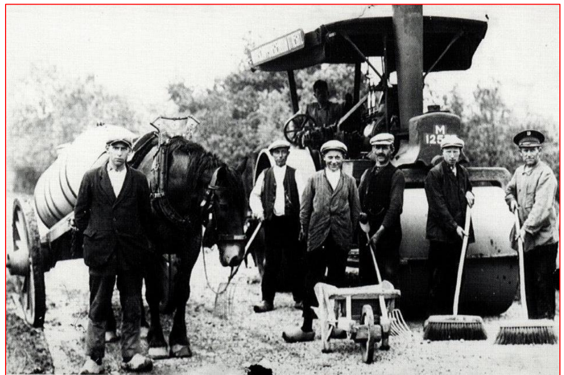
Boven; De 15 tons wegenwals tijdens het verharden of repareren van de Deurneseweg in Oploo. V.l.n.r. Jan Weemen, Piet Verberkt, Gerrit Erkelens, Tien Verberkt en Koos Erkelens.
